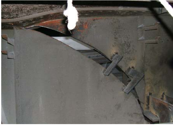
Fig. 1. The actual cracks of crane girder.
